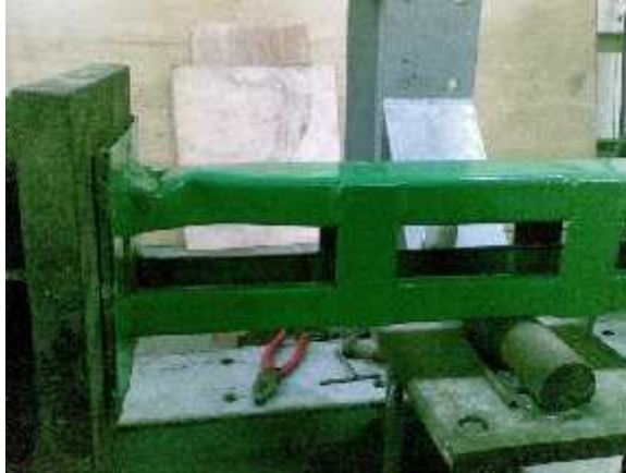
Gambar 1. Kegagalan kolom pendek tanpa pengisi beton ringan
