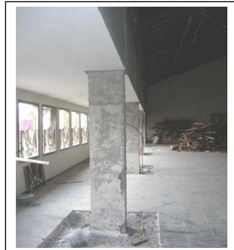
Gambar 8. Kolom yang dikelupas selimut betonnya.
