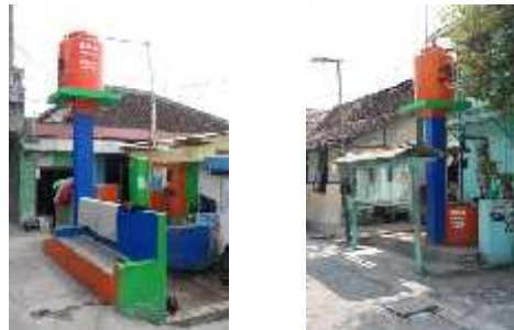
Gambar 1. Sanitasi Komunal di Permukiman Bantaran Sungai Winongo (sumber: survey 2010)
