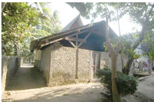
Foto 8. Penambahan Rangka Struktur Kayu pada Bagian Belakang Rumah no. 10. Sumber: Dokumen peneliti, 2011
