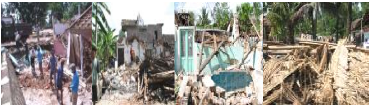
Gambar 4. Akibat Gempa terhadap Bangunan Sumber : Dokumen Penulis
