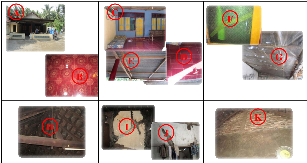
Gambar 7. Kondisi Rumah Ibu Suwardi, RT 03 No 12 Sumber: Survei Lapangan, 2011
