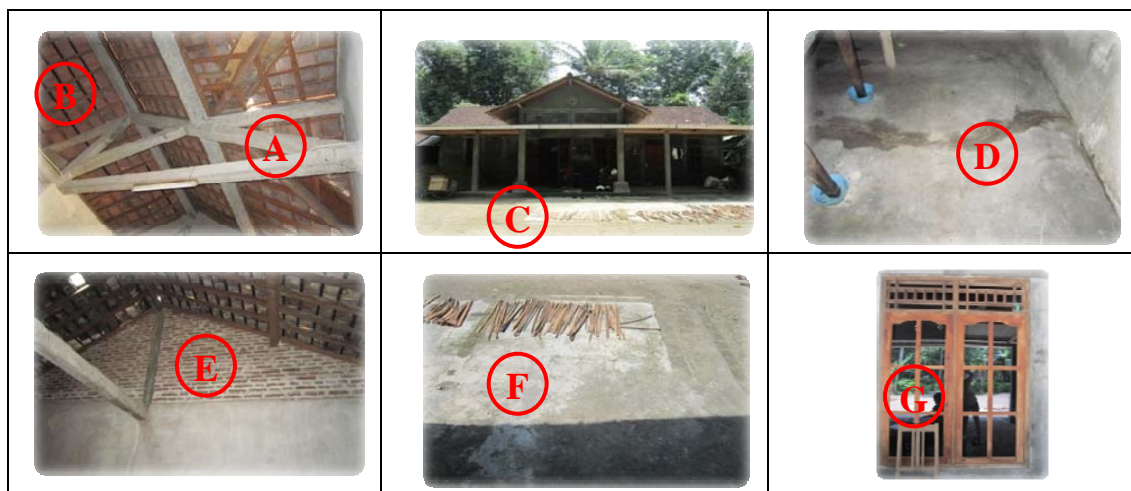
Gambar 2. Kondisi Rumah Bp. Ciptoharyono, RT 03 No.03 Sumber: Survei Lapangan, 2011
